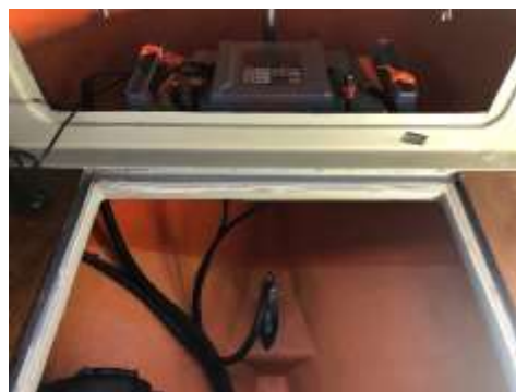
Motorrum med batterihylde over
